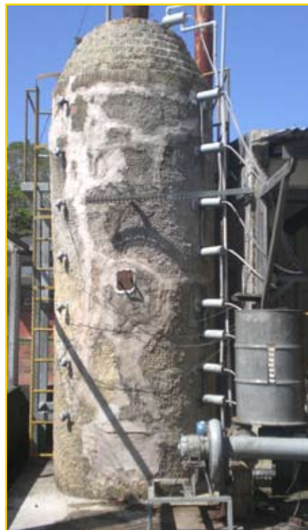
Câmara de combustão
